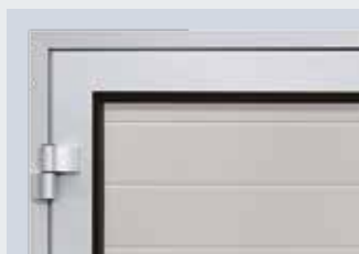
Вид изнутри с секциями
